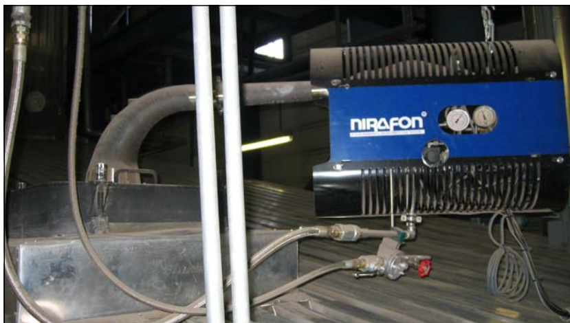
Третье устройство импульсной газоочистки Nirafon CSD, установленное на крышке экономайзера
